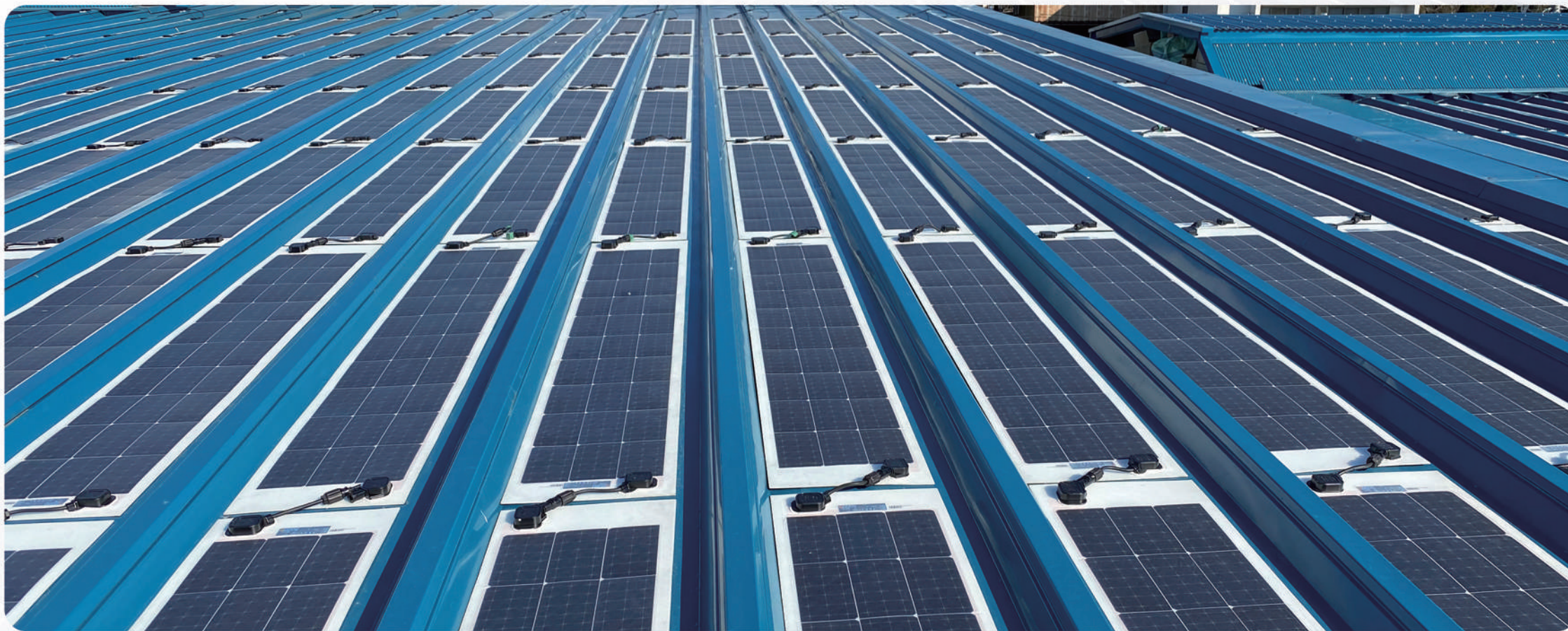
项目地点：日本 项目规模：290 kW
