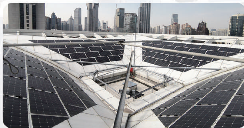
项目地点：中国·上海 项目规模：128 kW
